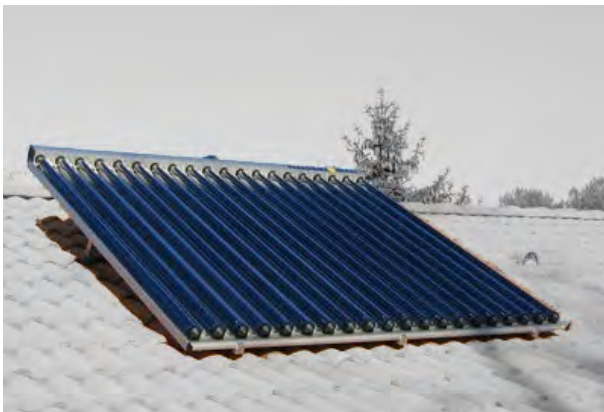
Capteurs solaires thermiques
