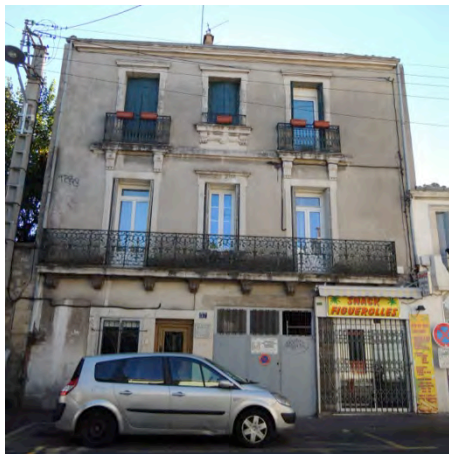
Le remplacement de la fenêtre par un modèle hétérogène nuit à l'harmonie d'origine.
